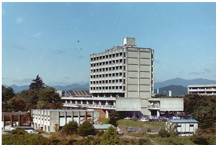
写真 S.1 うほ大 2 構内 某所 2011年3月11日3階床位置で9階までの柱4本が破壊 (p.580の写真 11.2)
